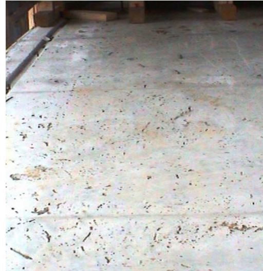
Abb. 9: Luftblasen auf der Oberseite eines kontergeschalteten Bogenstiels als Zeichen einer unzureichenden Betonentlüftung [13]
