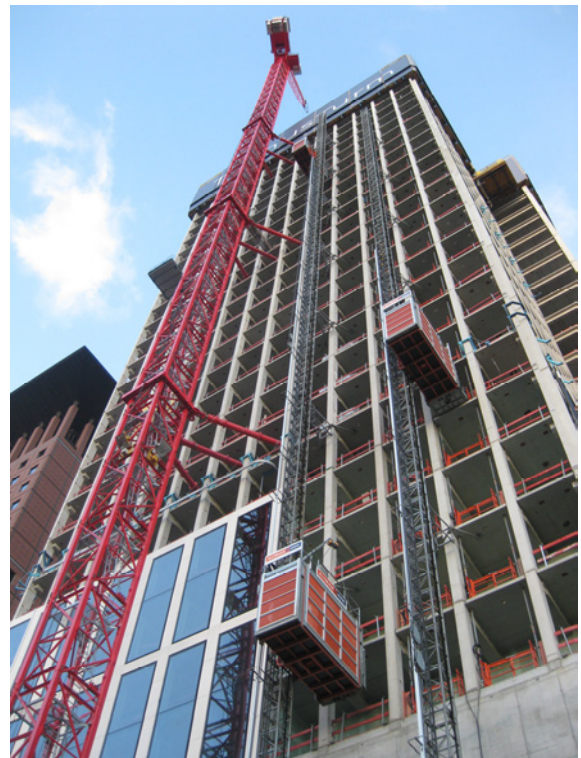
Abb. 1: Betonfertigteilbausystem beim Hochhaus Taunusturm in Frankfurt (Bauherr: Tishman Speyer Properties Deutschland, Ausführung: Ed. Züblin AG)
