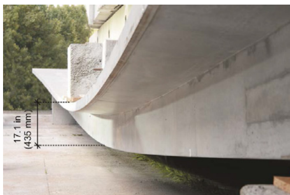
Abb. 19: Verformung des Brückenfertigteils: Längsansicht
