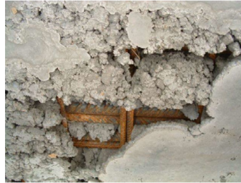
Abb. 11: Fehlstellen und Lunker in Folge eines zu schnell ansteifenden Betons mit falscher Zusammensetzung am 2. Bogenstiel der Bogenbrücke Wolkau [13]
