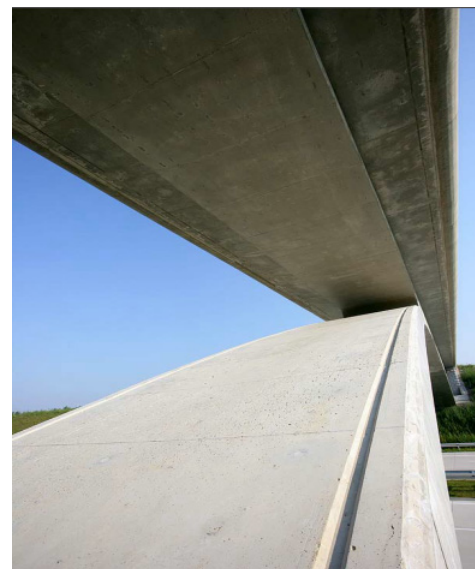
Abb. 10: Kontergeschaltete Oberfläche eines Betonbogens; Schalhaut wurde durch Einsatz eines Drucklufthammers leicht in Schwingung versetzt um ein Entweichen der eingeschlossenen Luftblasen zu begünstigen [13]
