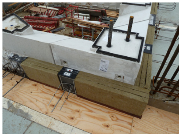
Abb. 4: Stützenstoß und Deckenanschlusselemente beim Bauvorhaben Ohligsmühle in Wuppertal (Ausführung: Ed. Züblin AG)
