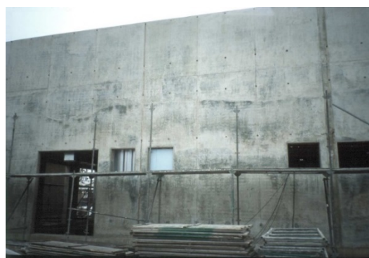
Abb. 23: Schüttagbildung infolge eines zu frühen Ansteifens der unteren Betonlage
