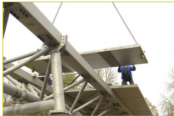
Abb. 24: Montage der Deckplatten bei der Gärtnerplatzbrücke in Kassel (Copyright: Fa. ELO Elementwerke Osthessen GmbH, Fulda)
