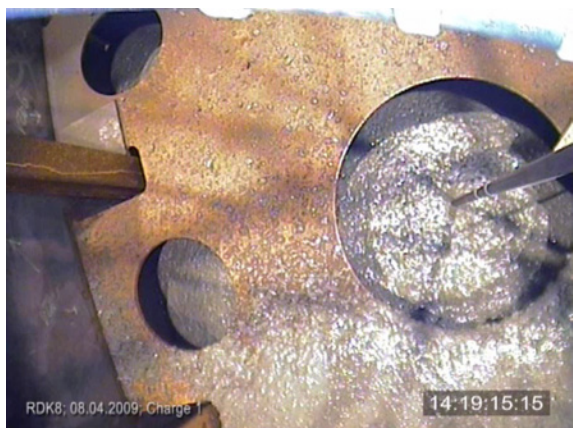
Abb. 21: Video-Standbild des Stützenquerschnitts mit von oben aus ca. 11 m Höhe einfallendem Beton: Der Beton schlägt auf dem Zwischenblech auf; keine Entmischungserscheinungen feststellbar
