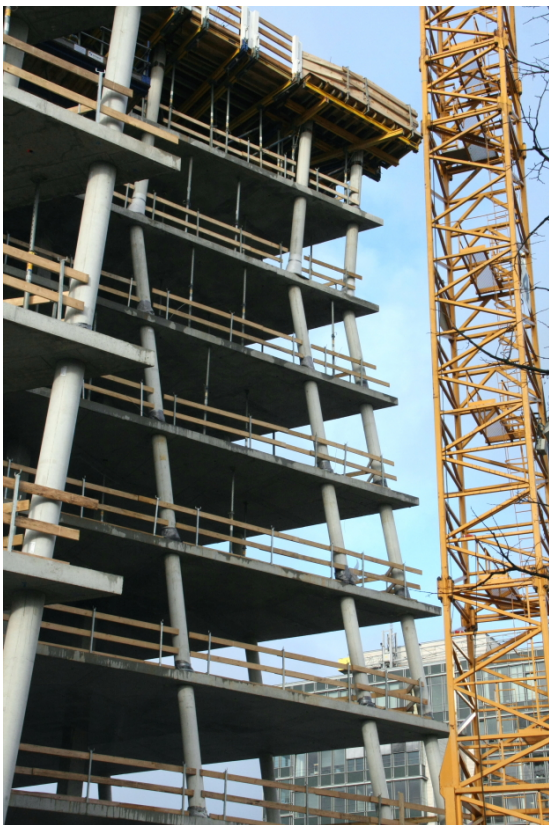
Abb. 2: Hochhaus Tanzende Türme in Hamburg (Bauherr: Strabag Real Estate, Ausführung: Ed. Züblin AG)
