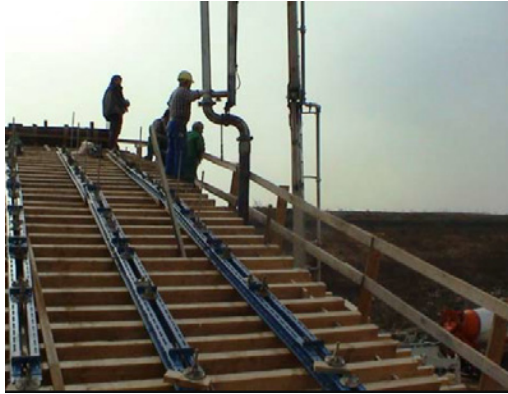
Abb. 8: Konterschaltung mit seitlich angeordneten Einfüllstutzen sowie Entlüftungsöffnung im Scheitelpunkt des Bogens bei der Betonage eines Segments der Bogenbrücke bei Wolkau [13]
