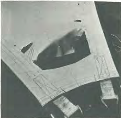
Bild 79: Bruch der Membranhaut im Anschlußbereich
