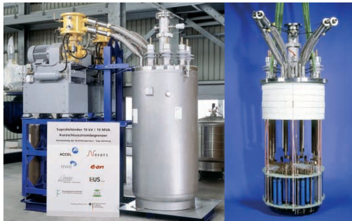
Der Kurzschlussstrombegrenzer CURL10 bestand den weltweit ersten Feldtest von April 2004 bis März 2005 im Netz der RWE bei Siegen
