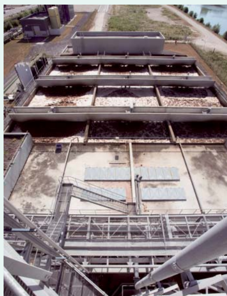
Das in Karlsruhe entwickelte Verfahren eignet sich für Kläranlagen mit Phosphatbelastung.
