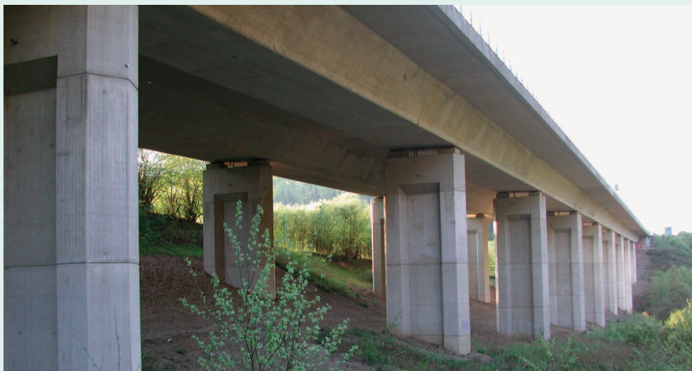
Das Testverfahren prüft den Zustand der im Innenraum freiliegenden Spannglieder von Hohlkastenbrücken und Schrägseilbrücken schnell und in situ.
