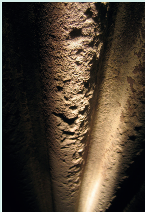
Korrosion der Kesseloberfläche.
