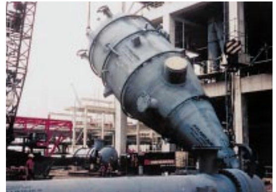
Abb. 3: Heißgasfilter für die Kohledruckvergasungsanlage in Buggenum, NL, bei der Montage 2) . Höhe 25 m, Durchmesser 4,2 m, Gewicht 90 t, Durchsatz ca. 25.000 \text{Bm}^3/\text{h} bei 240 °C und 22 bar entspricht 300.000 \text{Nm}^3/\text{h} .
