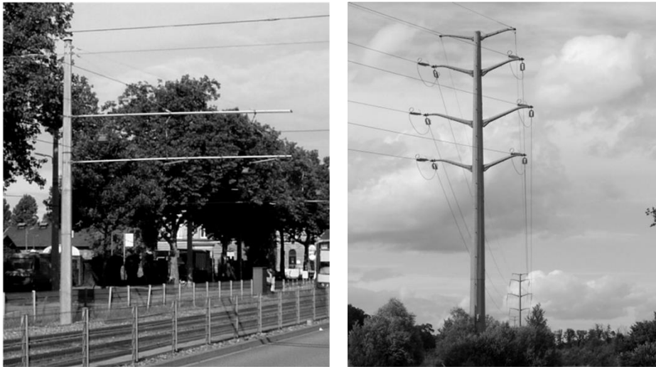
Abb. 1.1: links: Fahrleitungsmast, rechts: Freileitungsmast
