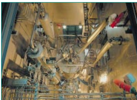
Abb. 8: Blick in die fernhandlungsfähige Schmelzofenzelle der inaktiven Prototypverglasungsanlage (PVA) des INE.
