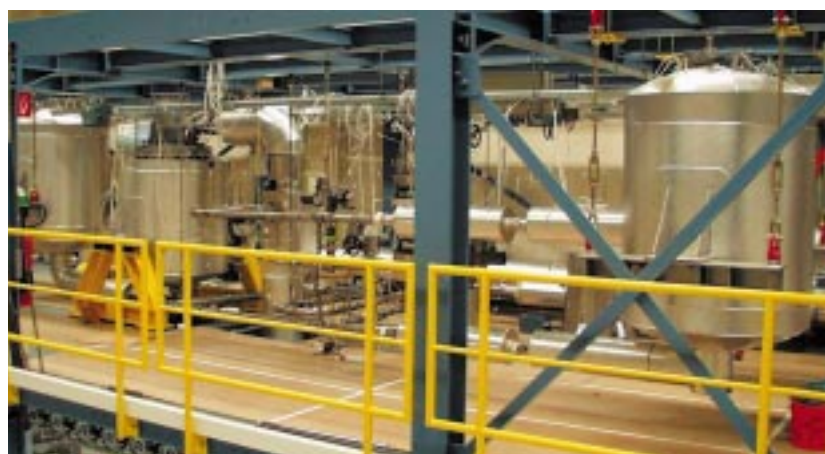
Abb. 4: THEADES-Teststrecke des KALLA-Labors zur Untersuchung thermo-hydraulischer Fragestellungen in Blei-Wismuth.
