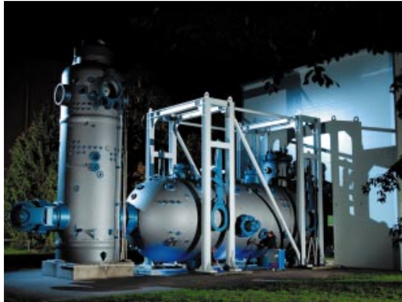
Abb. 1: Wasserstofftechnikum: Das Wasserstofftechnikum des Forschungszentrums wurde in enger Zusammenarbeit mit der Industrie aufgebaut. Hier werden Experimente zur Ausbreitung und Verbrennung von Wasserstoff durchgeführt, die für die Nukleare Sicherheitsforschung, aber auch für die konventionelle Nutzung von Wasserstoff als Energieträger benötigt werden.
