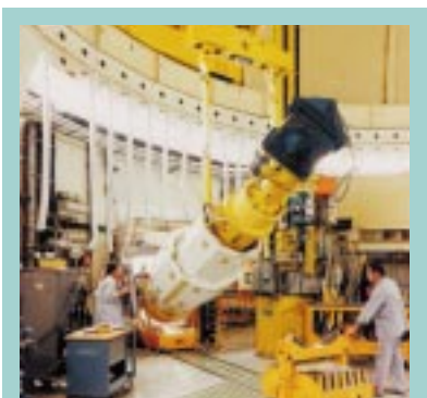
Vor dem Rückbau der Kompakten Natriumgekühlten Kernreaktoranlage (KNK) werden die Brennelemente aus dem Reaktorgebäude geschleust.
