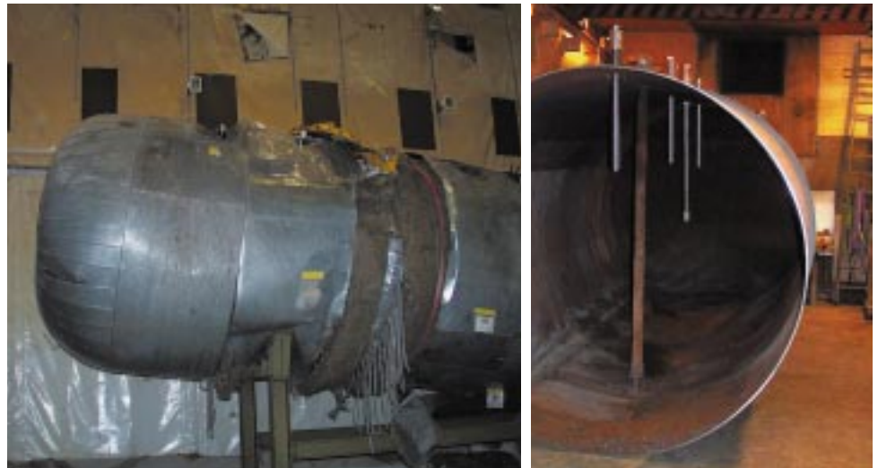
Abb. 2: Natrium-Ablasstank während der Sprühbefeuchtung zum Umsetzen des Natriums bei kontinuierlicher Überwachung der Wasserstoffkonzentration.
