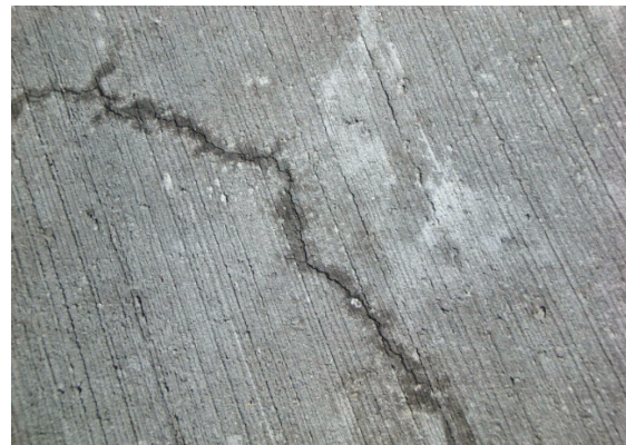
Abb. 2: Einzelriss in der Fahrbahnplatte
