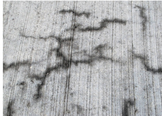
Abb. 1: Verästelte Frühschwindrisse in einer Stahlbeton-Fahrbahnplatte
