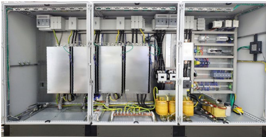
④ Schaltanlage mit Wechselrichtern und Versorgungseinheit Enclosure and power distribution fed by power supply unit and inverters
