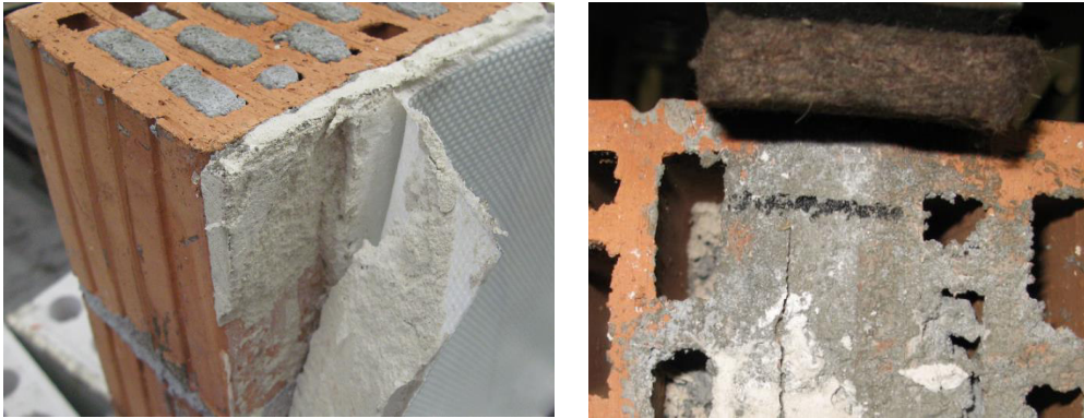
Abb. 4.91: Delamination zwischen Steinoberfläche und Putz (links), Verbleibende Druckzonen Höhe 1,5 cm durch gerissenen Querschnitt, (rechts)
