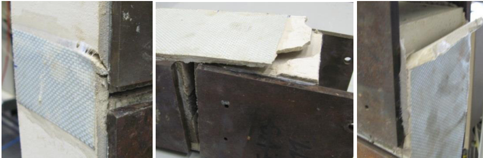
Abb. 4.9: Versagensfälle der Putzschicht bei unterschiedlichen Verbundlängen
