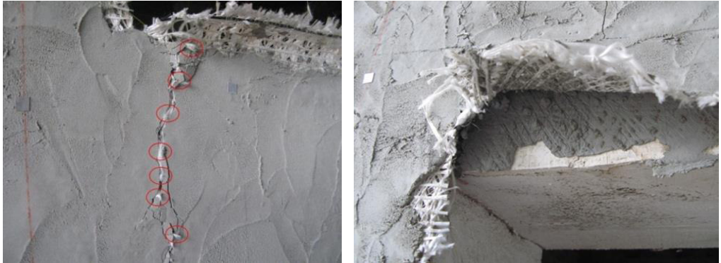
Abb. 4.58: Versagen der horizontal verlaufenden Glasfasern (rote Markierung) (links), Delamination am Holzsturz überhalb der unteren Türöffnung (links)
