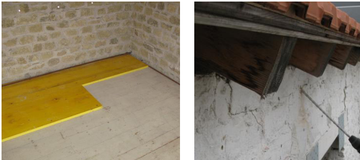
Abb. 4.55: Versteifung der Holzdecke mit Schaltafeln (links), Verbindung Mauerwerk zu Dach mit Stahldübelankern (rechts)
