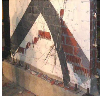
Abb. 3.18: Delamination der Verstärkung von dem Untergrund aus [187]
