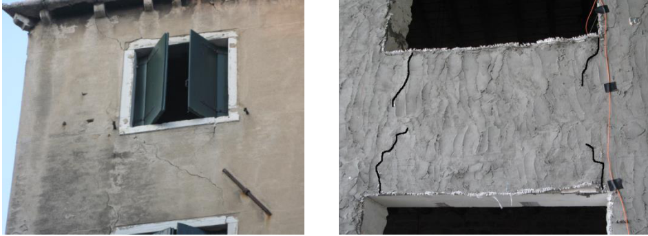
Abb. 4.22: Diagonale Schubrisse zwischen zwei Fenstern (links), Risse in einer Faserverstärkung (rechts), Detail aus Kapitel 4.22
