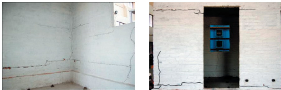
Abb. 4.69: Rissbild an der Ost-Süd-Innenseite (links), Rissbild an der Nord-Außenseite (rechts)
