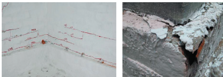
Abb. 4.77: Rissbild an der Nord-Ost-Ecke des Gebäude (G4) (links), Spaltrisse im Sockel an der Nord-Ost-Ecke (rechts)
