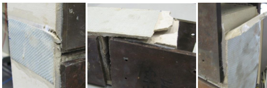
Abb. 4.9: Versagensfälle der Putzschicht bei unterschiedlichen Verbundlängen
