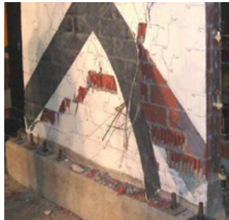
Abb. 3.18: Delamination der Verstärkung von dem Untergrund aus [187]
