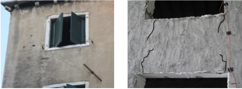
Abb. 4.22: Diagonale Schubrisse zwischen zwei Fenstern (links), Risse in einer Faserverstärkung (rechts), Detail aus Kapitel 4.22
