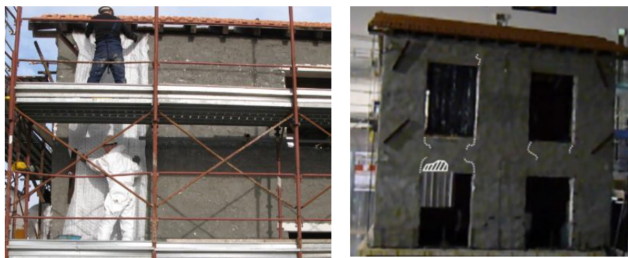
Abb. 4.56: Einbettung der durchgehenden Gewebehahnen (links), Geschädigtes Gebäude (G2), (gestrichelt Risse in Fasern und schraffiert Delamination) (rechts)
