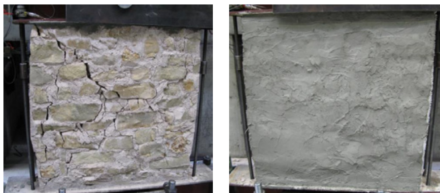
Abb. 4.24: Unverstärkte (links) gerissene Wand (W1) mit großen Einzelrissen, verstärkte (rechts) fein gerissene Wand (W2)
