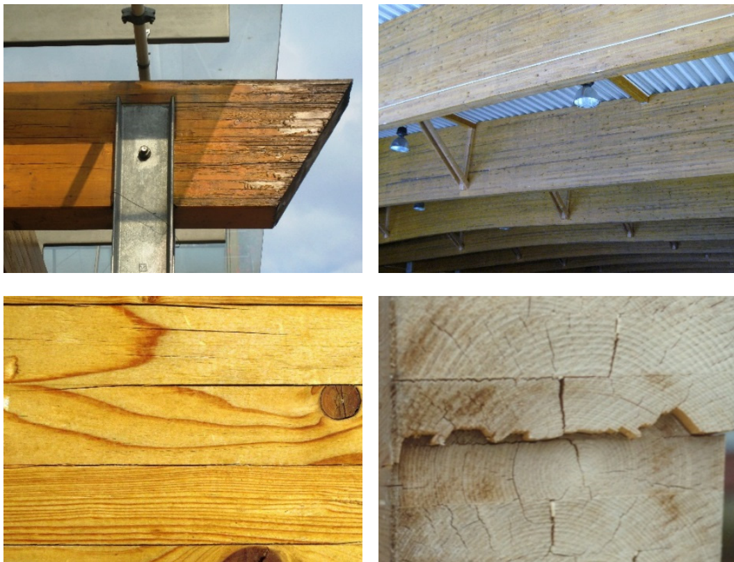
Bild 2: Initialschäden – Fäule ( oben links ), Bläue- oder Schimmelpilze ( oben rechts ), Risse in Faserrichtung (hier unbedenkliche Schwindrisse, unten links ), Schubbruch (Trägerhälfte der Druckzone tritt am Hirnholz hervor, unten rechts )
