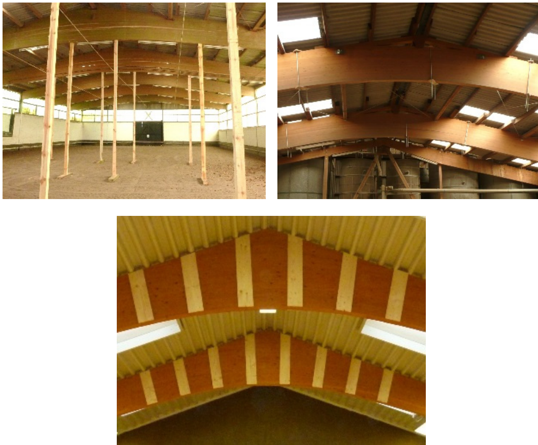
Bild 3: Risse in Satteldachbindern mit geneigtem Untergurt: sofortige Abstützung/Sicherung notwendig ( oben links und rechts ), fachgerecht ertüchtigte Binder ( unten )
