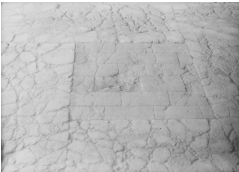
Abb. 339. Zerstörter Fußbodenbelag des Vestibüls, zentrales Quadrat, 1904 (SCA).
