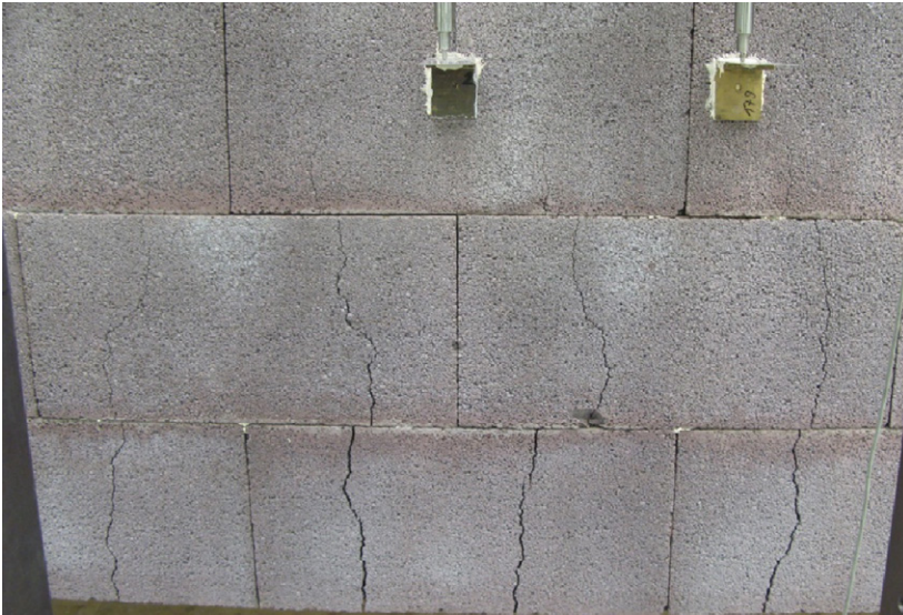
Abb. 6-17 Biegerisse im mittleren Drittel des Balkens
