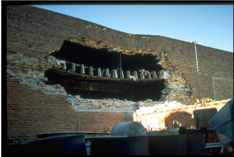
Abb. 2-2 Biegeversagen von Mauerwerkswänden aus der Ebene heraus [NISEE c]
