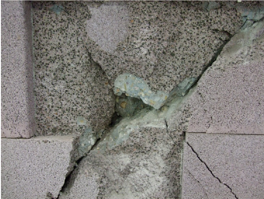
Abb. 4-13 Kreuzungsbereich der Risse
