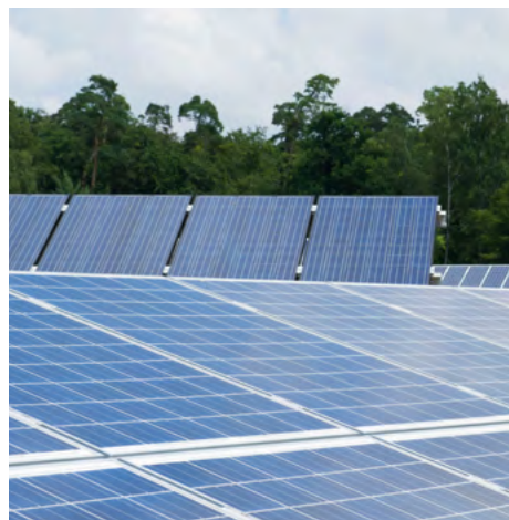
Am KIT betriebene Solaranlage. Die neuentwickelte, transformatorlose Wechselrichterschaltung kann die Effizienz solcher Anlagen erhöhen.
