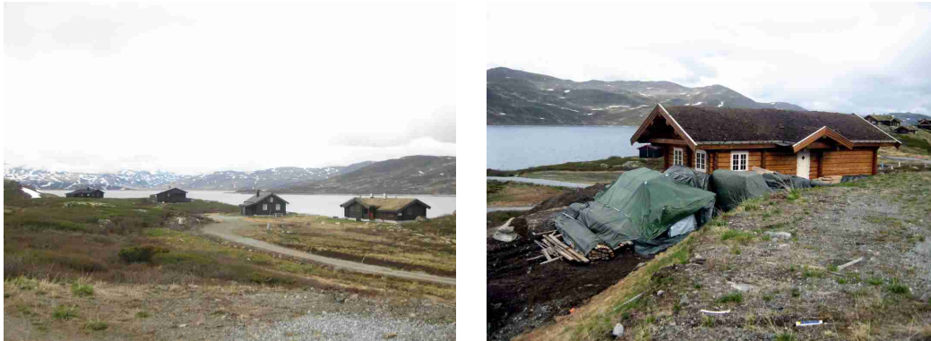
Abbildung 5.2.19: Holzhäuser in Blockbauweise. Neubau von Ferienhäusern am See Tyin, Norwegen 2011. Foto: Deist, Jörg.
