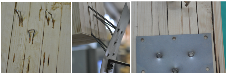
Bild 3-6 Typische Versagensbilder im Brettstapel. Im rechten Bild ist das Aufspalten der Lamellen deutlich zu sehen.
