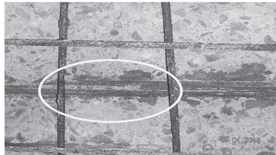
Abb. 4: Spanndrahtbruch (gelb markiert) in der Fahrbahnplatte einer Autobahnbrücke (Baujahr 1972) infolge Chloridkorrosion
