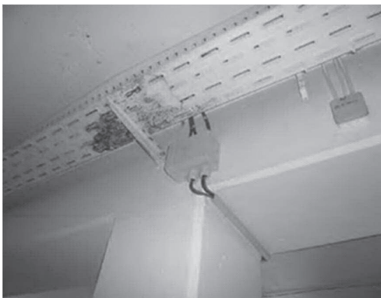
Abb. 4: Verteilerkasten für A/D-Wandler zur Potentialmessung
