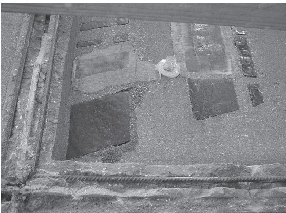
Abb. 4: Korrodierte Bewehrung in den Fenster- rahmen
