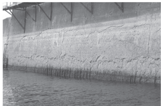
Abb. 9: Frostbedingte Zerstörung der Betonoberfläche im Bereich der Wasserwechselzone am russischen Wasserkraftwerk „Saratov“
