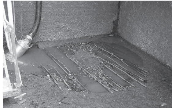
Abb. 11: Freilegung der Bewehrung im Sohlbereich einer wasserbaulichen Anlage
