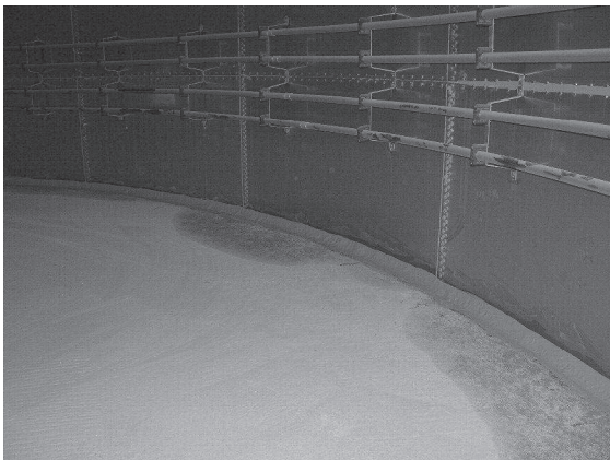
Abb. 9: Durchfeuchtung am Rand eines Biogasbehälters, orientierende Prüfungen mit dem Rückprallhammer ohne Bohrkernentnahme
