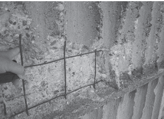
Abb. 5: Freigelegte Bewehrung Strukturbeton
