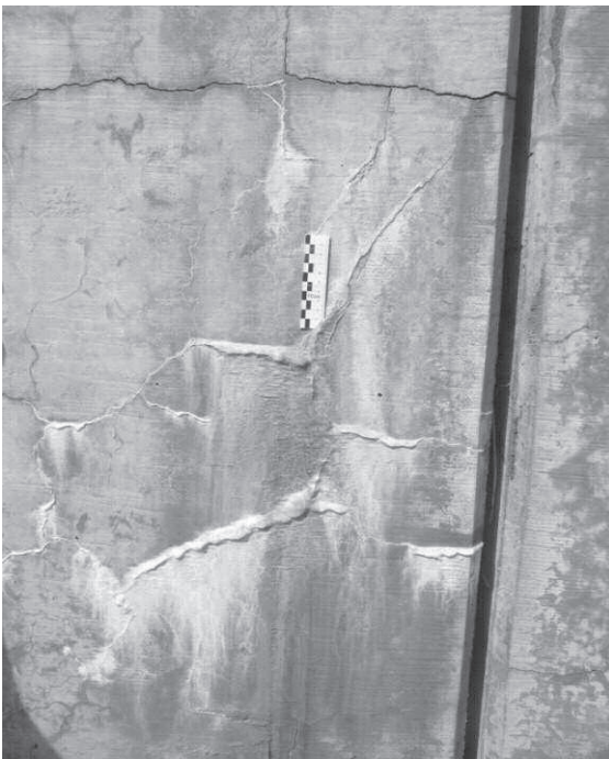
Abb. 6: Schädigung eines Brückenpfeilers infolge Alkali-Kieselsäure-Reaktion
