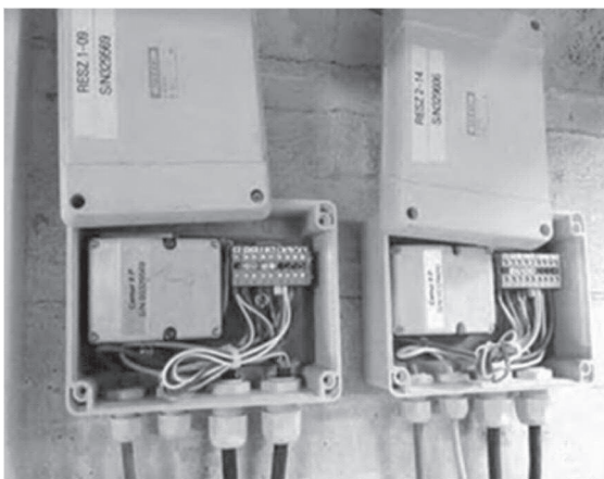
Abb. 5: Messknoten (A/D-Wandler) mit Verdrahtung
