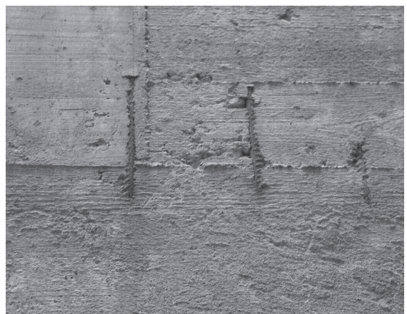
Abb. 2: Frei liegende Bewehrung in einer Betonwand
