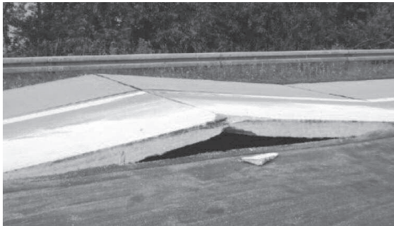
Abb. 8: Ausknicken von Platten/Plattenteilen (blow-up) bei Betonfahrbahndecken [21]
