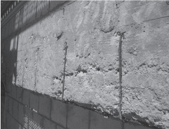
Abb. 3: Frei liegende Bewehrung, Fassade außen
