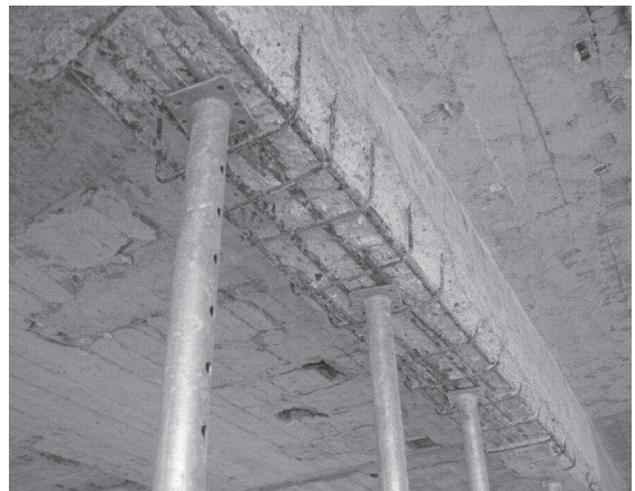
Abb. 1: Frei liegende Bewehrung an einem Unterzug
