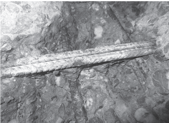
Abb. 14: Geringe Korrosion im freigelegten Bodenriss
