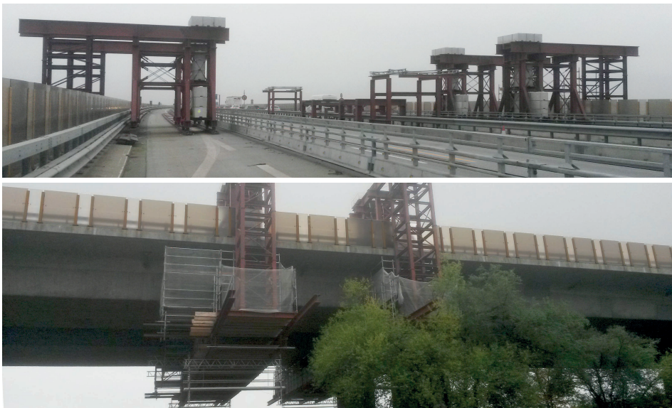
Abbildung 6.35: Sanierung der Hohlkästen einer Spannbetonbrücke und erforderliche Verkehrsführung 2+2 der oben liegenden Autobahn
