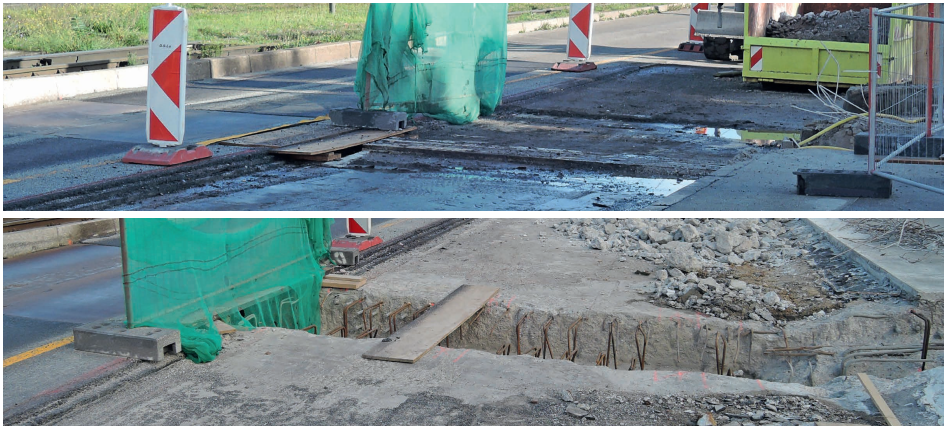
Abbildung 4.7: Ablauf des Austauschs eines Fahrbahnübergangs, eingebauter Zustand mit abgetragenem Asphalt (oben) und ausgebauter Zustand mit sichtbarer Anschlussbewehrung (unten)
