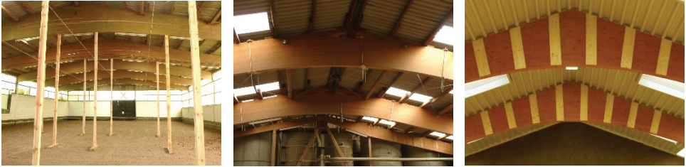
Bild G4-3 Risse in Satteldachbindern mit geneigtem Untergurt: sofortige Abstützung/Sicherung notwendig (links und Mitte), fachgerecht ertüchtigte Binder (rechts)
