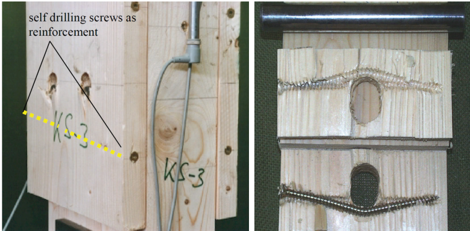
Bild E12-3 Mit Vollgewindeschrauben verstärkte Verbindungen. Links: Verstärkung mit Abstand zu den Stabdübeln (Schmid, 2002). Rechts: aufgetrennter Versuchskörper nach Versuch mit Verstärkung direkt unter dem Stabdübel (Bejtka, 2005a).
