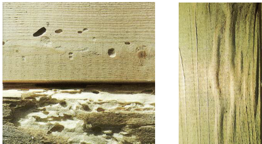
Bild B3-17 Hausbockbefall. Links: Fluglöcher und Zerstörung unter der intakten Holzoberfläche. Rechts: Aderartige Aufwölbungen, die auf einen Hausbockbefall hinweisen. (Sutter, 1997)
