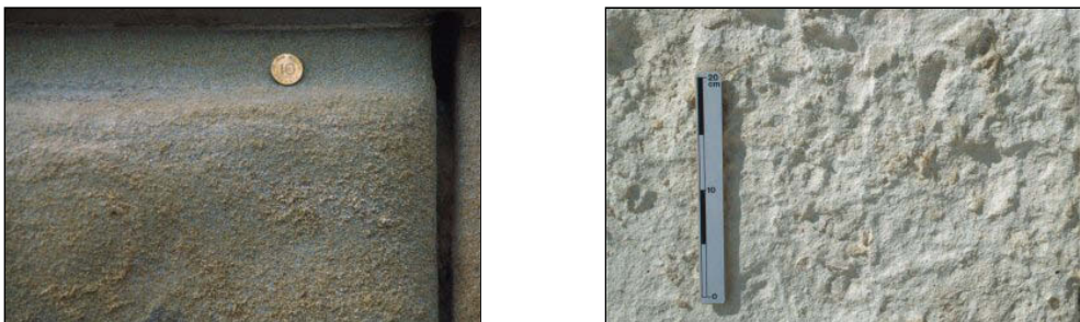
Abb. 2.25: Absanden (links) und Abmehlen (rechts) in Sandsteinen, Bildbreite links ca. 30 cm, rechts ca. 45 cm [44]
