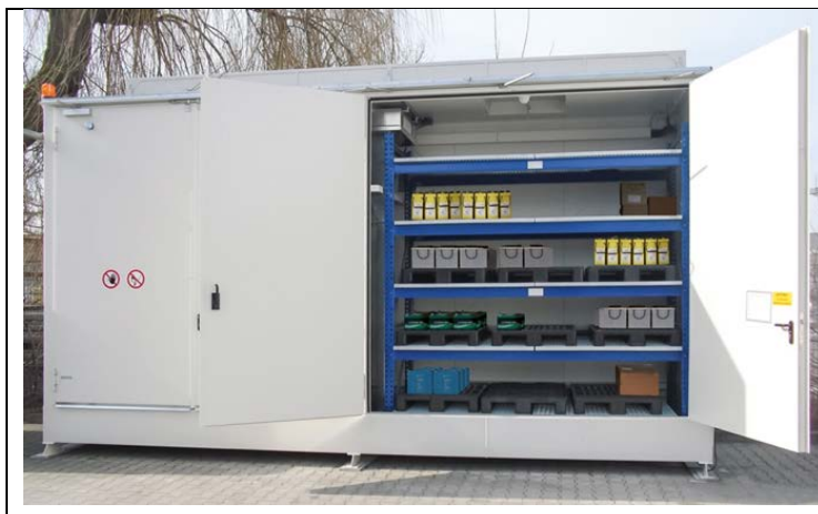
Abbildung 6: Beispiel für einen Lagerraum für Lithium-Ionen-Batterien mit Feuerwiderstand F90 bzw. REI 90 von innen und außen [Denios /2015/]
