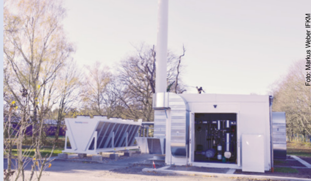
Blockheizkraftwerk im Campus Ost versorgt KIT-Gebäude mit Wärme und Strom.
