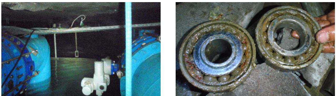
Abbildung 4.7: Überflutung der Anlage Bribin (Januar 2011) führte zu Verunreinigung der Maschinen
