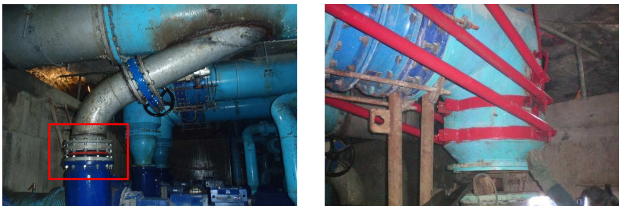
Abbildung 4.30: Einsatz von Axialkompensatoren zur Lastreduzierung am PAT-Druckstutzen bei den Modulen 3, 4 und 5 (links), Installation von Aufhängungen für die PAT-Druckrohre (rechts)
