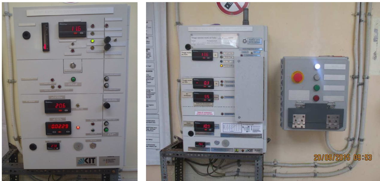
Abbildung 4.5: Schaltschrank des Kontrollsystems in Bribin vor der Umgestaltung (links), nach der Anpassung zusammen mit dem Notaussystem (rechts)
