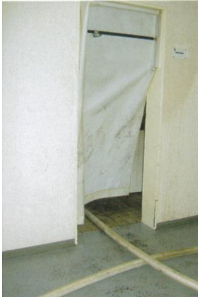
Abbildung 3.1: Der mobiler Rauchverschluss wurde im Türrahmen einer Wohnungsabschlusstür installiert [33]. Im vorliegenden Fall war es die Tür zu einem Raum mit Waschmaschinen und Wäschetrockner in einer großen Wohneinheit [50].
