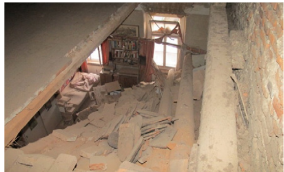
Abb. 3 Deckeneinsturz in Graz, vgl. [11]
