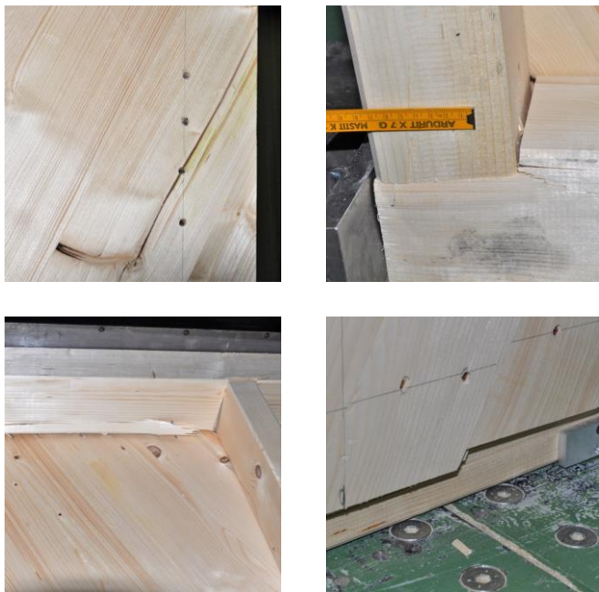
Bild 7-10 Riss in Beplankung oben links, Querdruckversagen der Schwelle oben rechts, Rillennagelverbindung mit Querkzugversagen im Rähm unten links und Verschiebung zwischen zwei Brettern der Beplankung unten rechts
