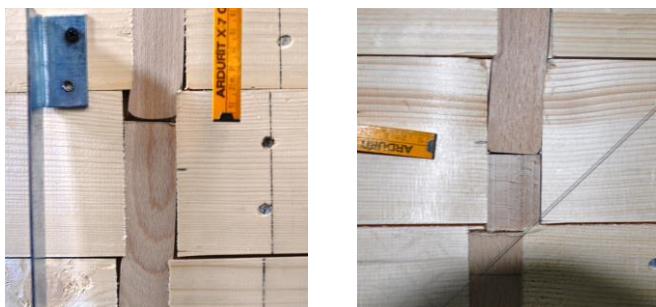
Bild 7-8 Geringe Einbindetiefe, Leiste nicht über halbe Brettbreite eingeschoben links und in Scherfuge abgetrennte Leiste rechts
