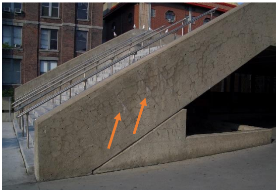
Abb. 1: AKR-Schaden an Betontreppe, Palais des congrès de Montréal, Kanada (Foto Middendorf)
