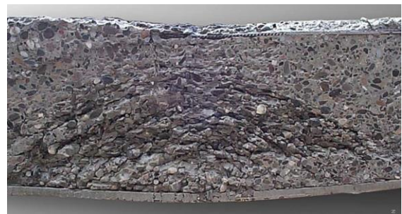
Abb. 7: Trümmerschutzdecke aus DUCON-Beton® nach der Explosionslast [27]
