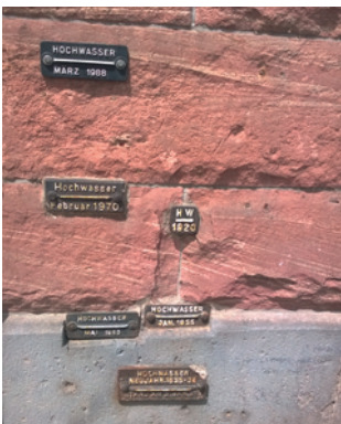
Abb. 31 Hochwassermarken am Gebäude
