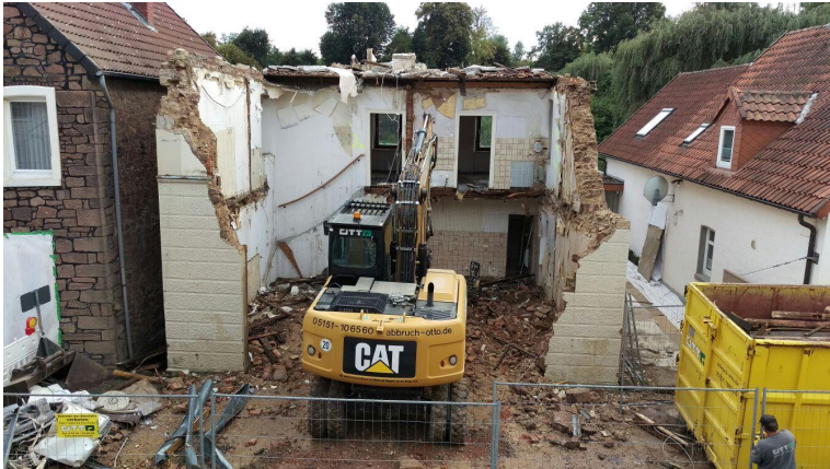
Abbildung 58: Abbruchobjekt Lemgo: Abbruch Dachstuhl und Decken EG und OG, rechts Sortierung Holz
