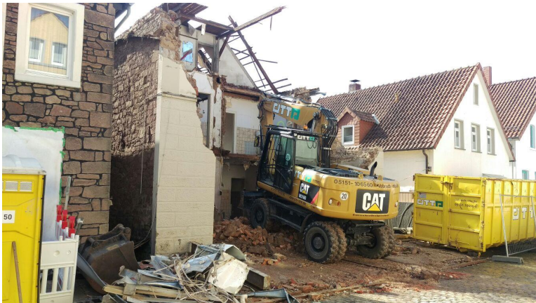
Abbildung 57: Abbruchobjekt Lemgo: Straßenfront des Gebäudes ist abgebrochen, im Vordergrund Sortierungshaufen Stahl und Kupfer
