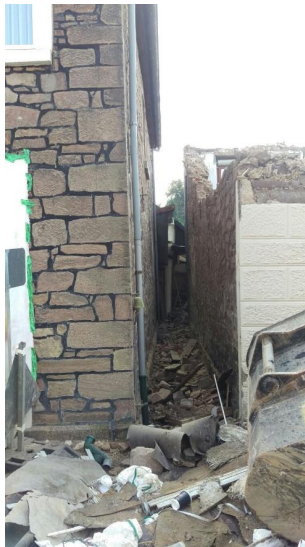
Abbildung 59: Abbruchobjekt Lemgo: Abstand zum Nachbargebäude (links), Sortierungshaufen Vermüllung
