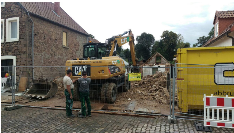
Abbildung 61: Abbruchobjekt Lemgo: Vollständiger Abbruch Gebäude Orpingstraße Lemgo, lediglich die Remisen müssen noch abgebrochen werden
