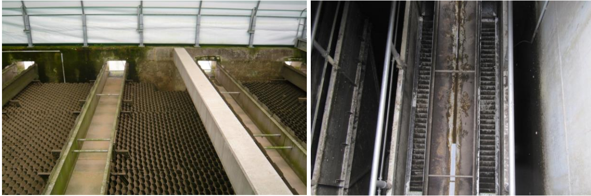
Bild 4: RÜB Göbrichen (linkes Bild); RKB 102 „Klimm Klamm“ mit Blick von oben auf die Klarwasserrinne und die darunter liegenden Lamellen (rechtes Bild)
