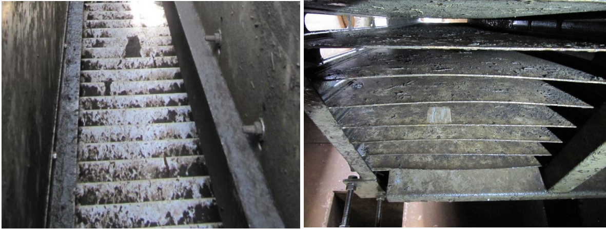
Bild 8: Sedimentauflage im Trennsystem (Plattenabscheider)
