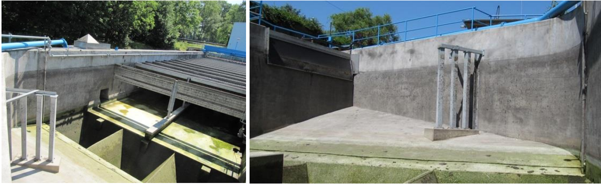
Bild 5: RÜB Homberg-Hakenfeld (Linkes Bild mit Blick auf die Sedimentationskammer; rechtes Bild mit Blick auf das Einlauf- und Verteilerbauwerk)
