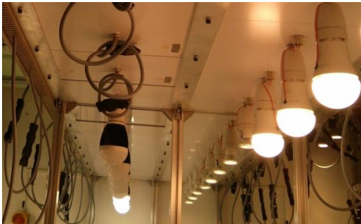
Abbildung 5.8: Langzeitmessstand im Betrieb mit bereits defekten LED-Systemen in der linken Reihe
