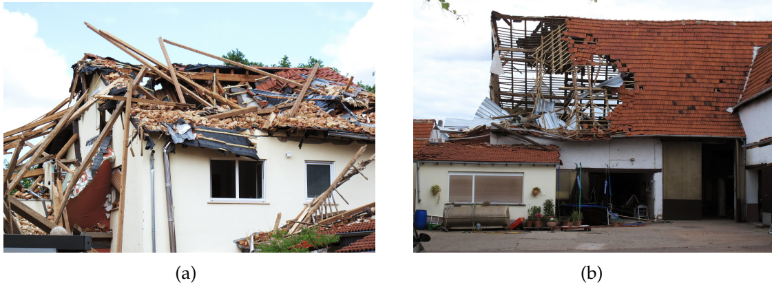
Abbildung 9.2: Windschäden an Gebäuden Framersheim nach Downburst vom 7.7.2015, © Susanna Mohr, KIT.
