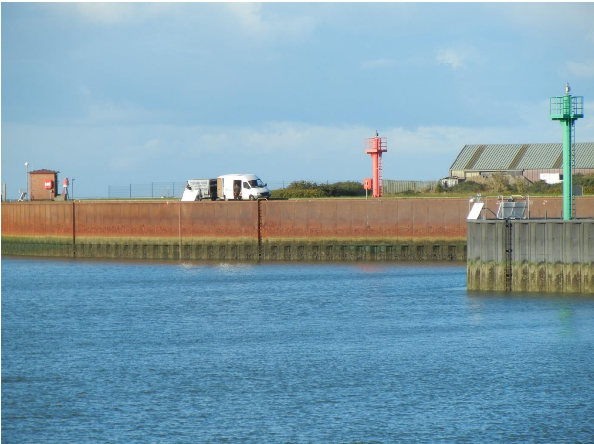
Abbildung 14: Spundwände auf Borkum mit erkennbarem Tidehub und atmosphärischer Korrosion
