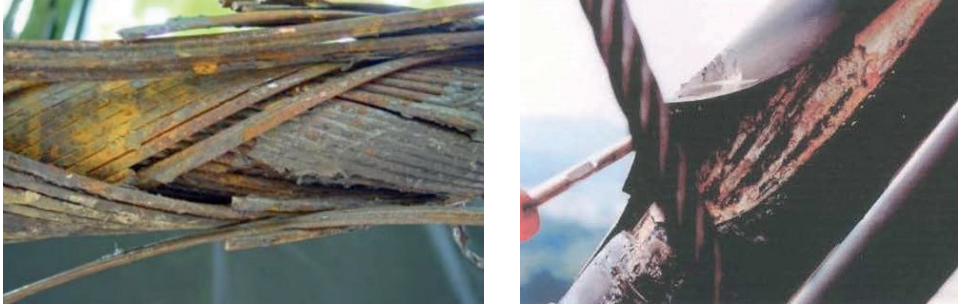
Abb. 2-15: Infolge Korrosion gerissene Drähte eines Schrägseils (links) [60], Korrosion an den Spanndrähten der Restaurant- und Shoppingbrücke im Kanton Aargau (rechts) [77]
