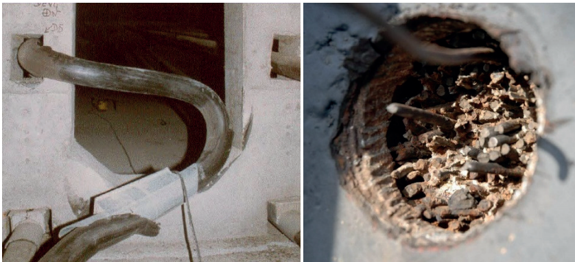
Abb. 1-6: Infolge Korrosion gerissenes externes Spannglied (links) und Schrägseil (rechts) [60]
