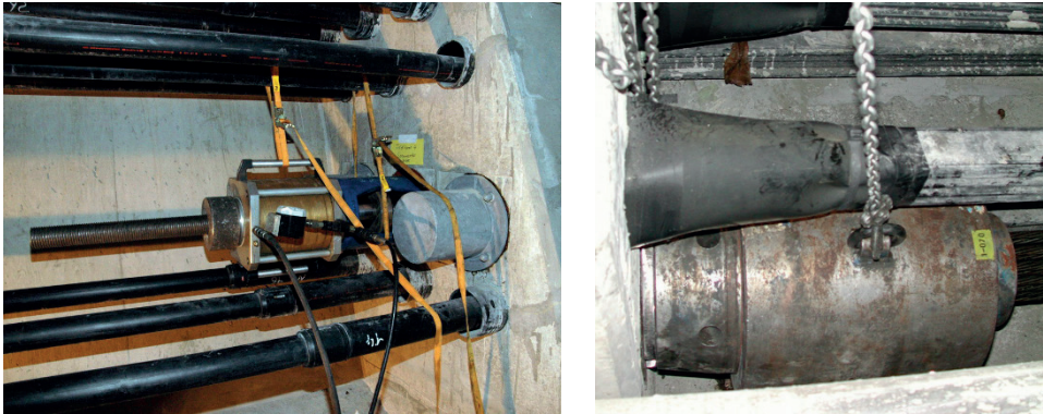
Abb. 4-5: Ansetzen der Spannpresse in der Talbrücke Berbke (links) und in der Talbrücke Rümmecke (rechts)
