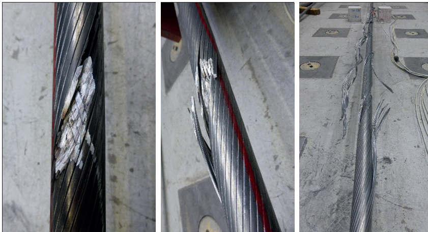
Abb. 3-17: Gegenseitige Fixierung bei wenigen gebrochenen Drähten (links), leichte Abwicklung einiger Profildrähte (Mitte), Abwickeln der Profildrähte über große Länge (rechts)
