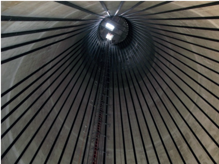
Abb. 2-7: Externe Spannglieder in einer Windenergieanlage
