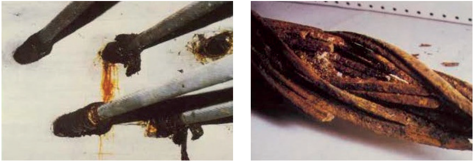
Abb. 2-17: Große Naabbrücke, Korrosionsspuren im Bereich der Durchführung (links), Bruchstelle eines korrodierten Stahlseils [25]
