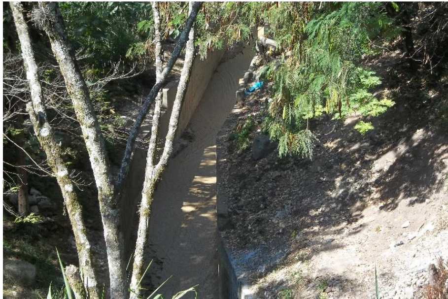
Abbildung 21. Fließgewässer La Ana Díaz (Abschnitt 4) belastet durch Direkteinleitung aus der Produktion von Zuschlagsstoffen im Steinbruch (Bild: Luisa Roldan)
