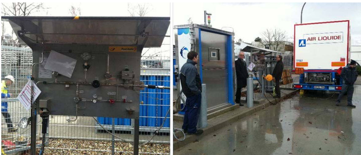
Abbildung 10: Behelfstankanlage entliehen von Postauto Schweiz im Dezember 2012
