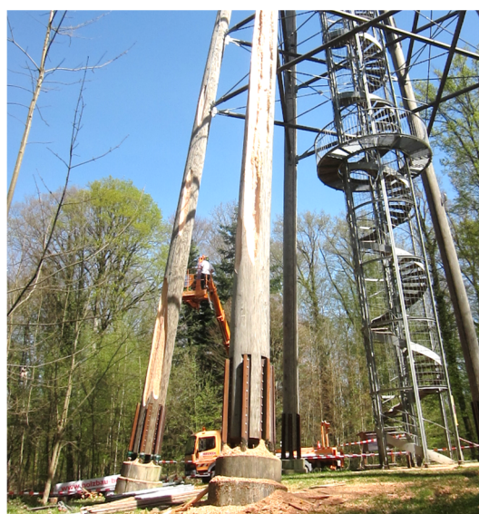
Abb. 2 Schäden am Eichbergturm
