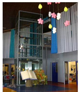
Abb.73 Aufzugsanlage zur Erschließung der Wohnungen
