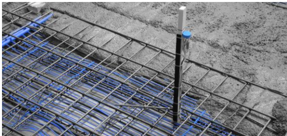
Abbildung 10: Sensorbaum im Tragwerk
