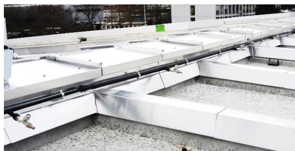
Abbildung 6: Berieselungssystem auf dem Dach
