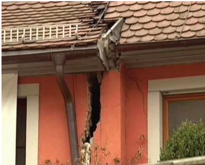
Abb. 17: Gebäudeschäden in Staufen (Quelle: tv Südbaden, 22.03.2012).
