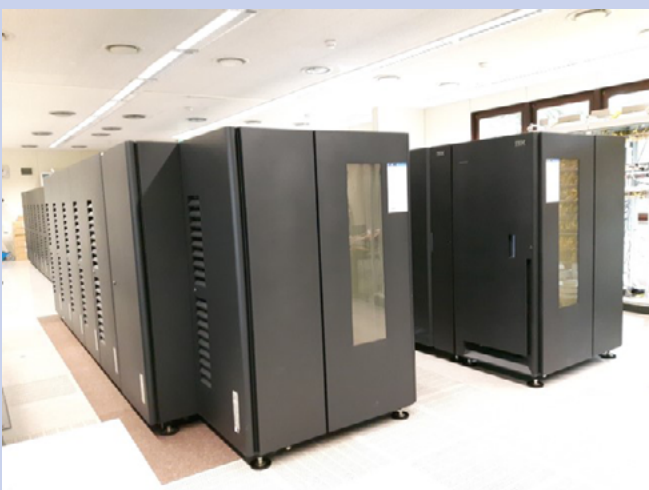
Bild 2: TS3500 Bandbibliothek Gebäude 141, Campus Nord
