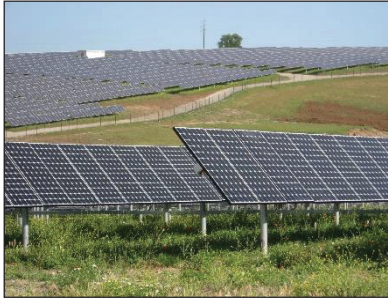
Imagen: instalación fotovoltaica a gran escala (Fuente de imagen: Ceinturion, https://commons.wikimedia.org/wiki/File:SolarPowerPlantSerpa.jpg , „SolarPowerPlantSerpa“, https://creativecommons.org/licenses/by-sa/3.0/legalcode )
