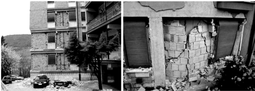
Abbildung 3-3: Out-of-plane Versagensfälle nach dem L'Aquila Erdbeben (Braga et al. [19]): Out-of-plane mit zwei Körper Gelenk-Kinematik
