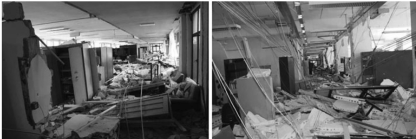
Abbildung 3-4: Out-of-plane Versagensfälle nach dem L'Aquila Erdbeben (Braga et al. [19]): Schäden an Trennwänden in Gebäuden
