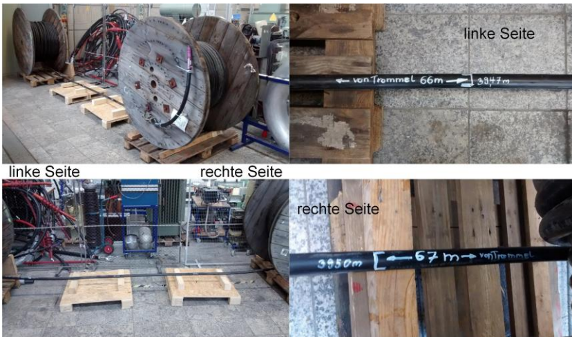
Abb. 154: Mittelspannungskabel auf zwei Trommeln aufgeteilt und mit einem ca. 3 m langen Mittelstück zur Montage einer Wärmequelle
