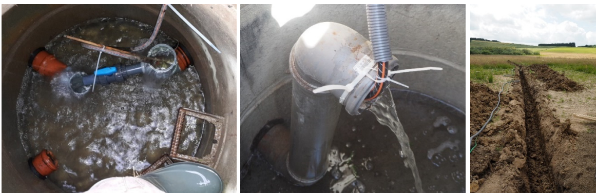
Abbildung 14: Anbringung der Schläuche im Zulaufrohr (links) und im Ablaufrohr (mitte) der Anlage D7 sowie die unterirdische Verlegung der Schläuche (rechts). (Fotos: Victoria Griebmeier).
