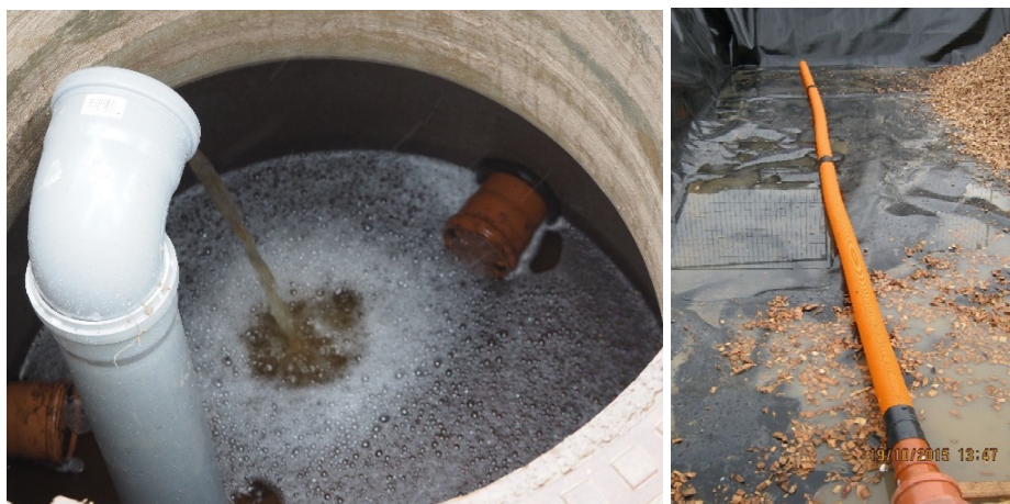
Abbildung 12: Ablaufschacht der Anlage (links) mit nach oben ragendem Rohr zur Anstauung des Wassers im Becken. Das Ablaufsammelrohr (rechts) am Beckenboden der D7 (Fotos: Victoria Griebmeier; Christian Schulz, SWT Schulz Wassertechnik).
