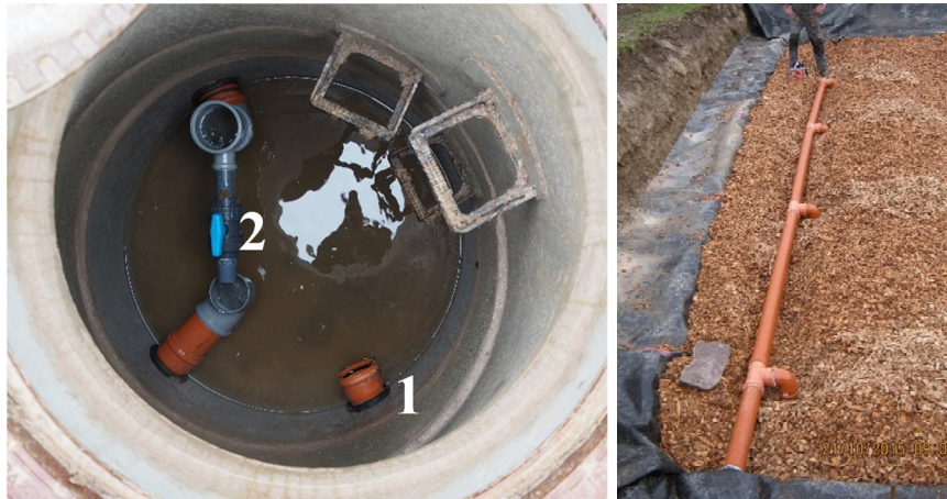
Abbildung 11: Zulaufschacht mit Bypass-Rohr (1) und Zulaufdrossel (2) an der Anlage D7 (links). Zulaufverteiler in das Denitrifikationsbecken (rechts) (Fotos: Victoria Griebmeier; Christian Schulz, SWT Schulz Wassertechnik).
