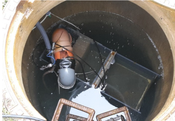
Abbildung 25: Vollgelaufener Ablaufschacht im Januar 2018.
