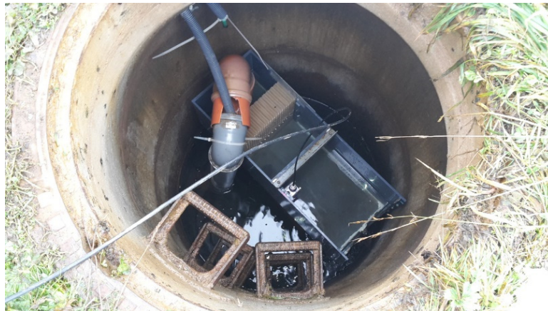
Abbildung 17: Thomsonwehr im Ablaufschacht der Umweltdenitrifikationsanlage zur kontinuierlichen Erfassung der Flussrate (Foto: Victoria Griefmeier).
